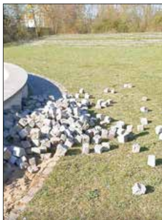
Zahlreiche Pflastersteine wurden herausgerissen und auf dem Gelände verteilt. © Stadt Guben
