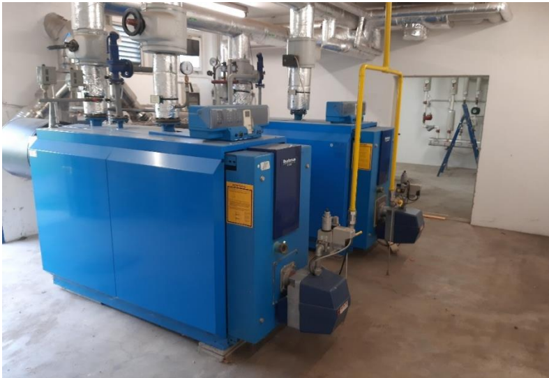
Abbildung 14: Alte Kesselanlage Europaschule
