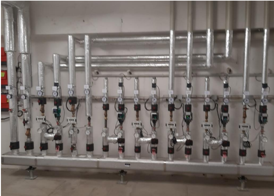
Abbildung 17: Neue Wärmeverteilungsanlage Turnhalle Europaschule
