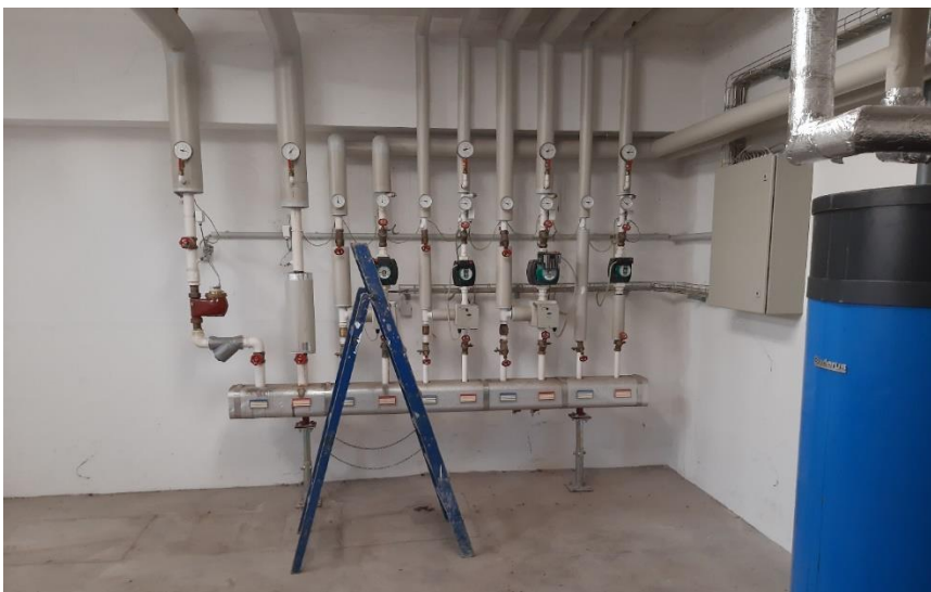
Abbildung 16: Alte Wärmeverteilungsanlage Turnhalle Europaschule
