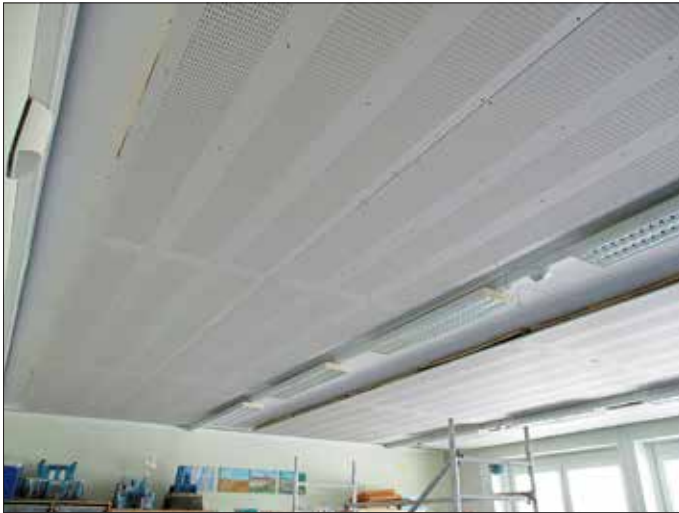
Wandabsorberplatten bieten ab sofort einen verbesserten Schallschutz in der Corona-Schröter-Grundschule. Foto: Stadt Guben
