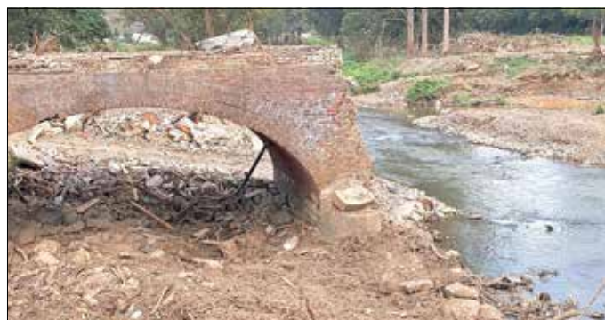
Eine zerstörte Brücke im Ahrtal. Foto: Philipp Humbsch
